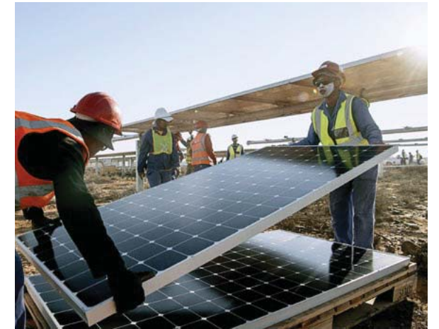
Centrale solaire SunPower Total, Prieska, Afrique du Sud.
