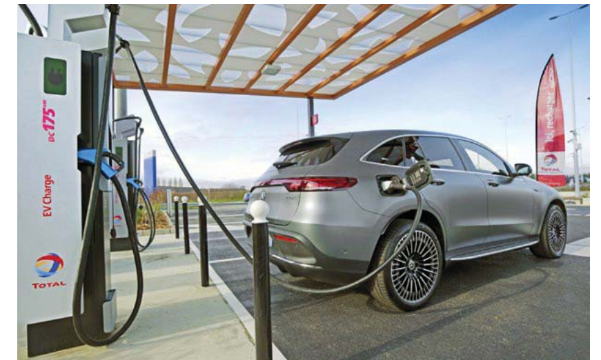
Borne de recharge sur l'aire de Limours-Janvry en France.
